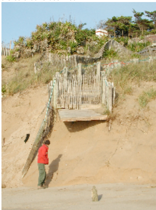
L'escalier d'accès à la plage de la Martinière suspendu sous 3 mètres de vide
